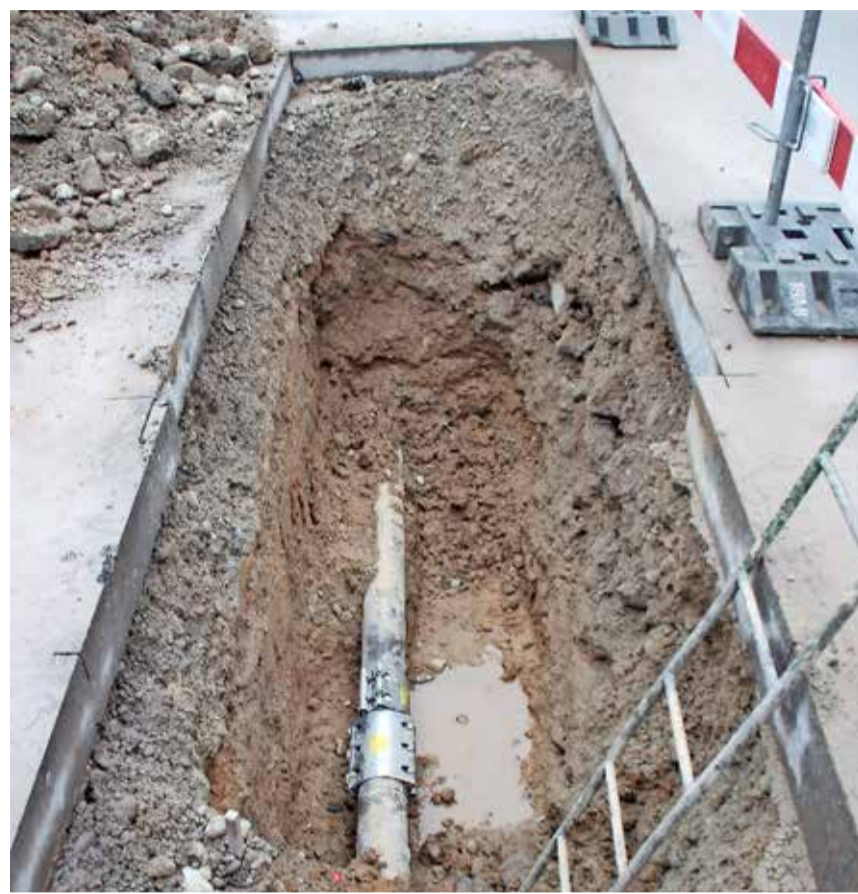
Der enorm grosse Bedarf an Löschwasser führte am Sonntagmorgen in Benken gleich zu mehreren Rohrleitungsbrüchen. Bild Roland Müller
