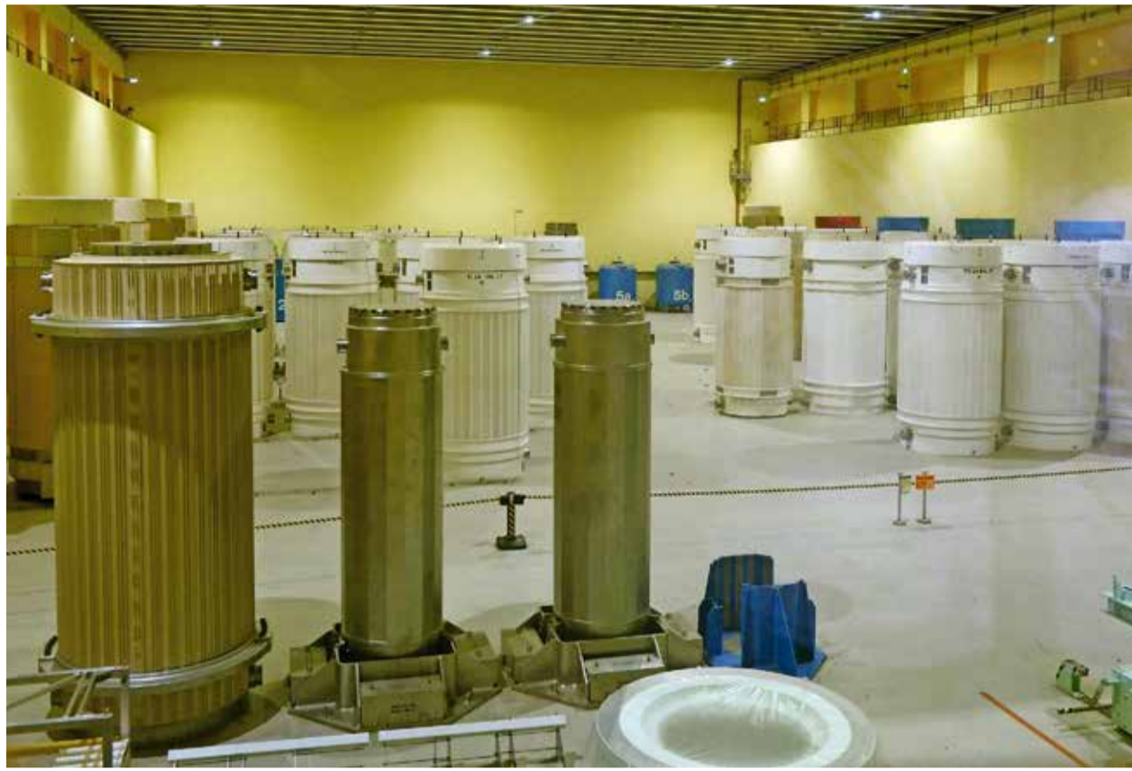
Wo die radioaktiven Abfälle – hier im Zwischenlager Würenlingen AG – einst vergraben werden, ist noch nicht beschlossen. Der jetzt veröffentlichte Leitfaden gibt aber bereits vor, wann und wie über Abgeltungen verhandelt werden soll. Bild Key
